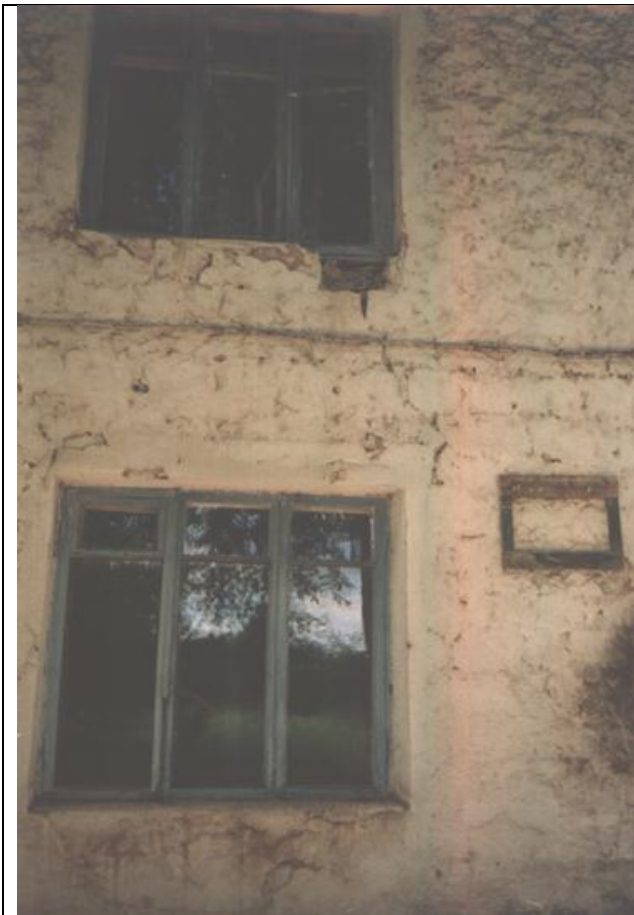
Мал. 3.53 - Похилі тріщини в стіні будівлі школи по вул. Планетарній, 47 в селищі Верабово
