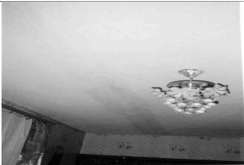
Рис. 3.4. Житловий будинок по вул. Бірюзова, 7. Окремі закладені тріщини в плитах перекриття
