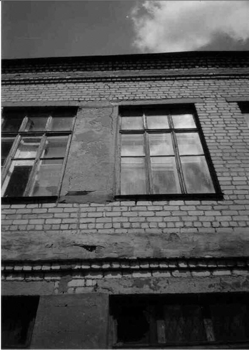
Рис. 3.6.3. Пошкодження будівлі середньої школи № 40 по вул. Сестрорецькій.
