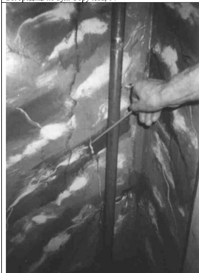
Рис. 3.25 – Вертикальні тріщини в стіні Церкви Різдва Богородиці по вул. Обручева, 14
