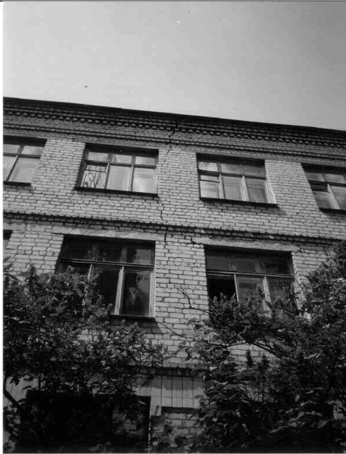
Рис. 3.6.1. Пошкодження будівлі середньої школи № 40 по вул. Сестроріцькій.
