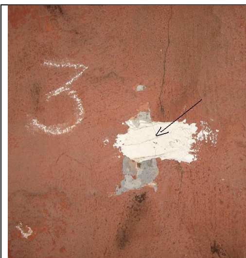
Рисунок 4.21 – Утворення тріщин в стіні будівлі школи після вибуху 10.09.08
