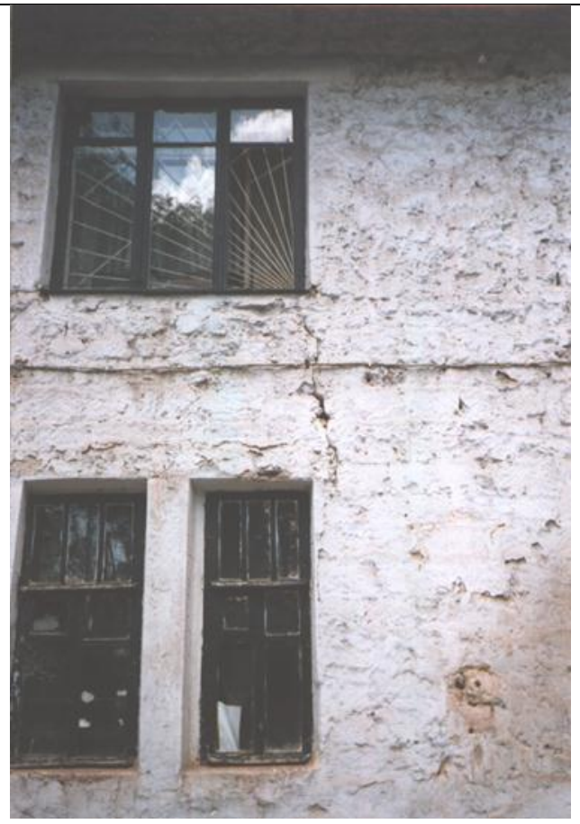
Рис. 3.54 – Похилі тріщини в стіні будівлі школи по вул. Планетарній, 47 в селищі Верабово
