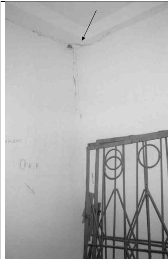
Рис. 3.29 – Тріщини в стиках несучих конструкцій будівлі по вул. Ярославській, 1
