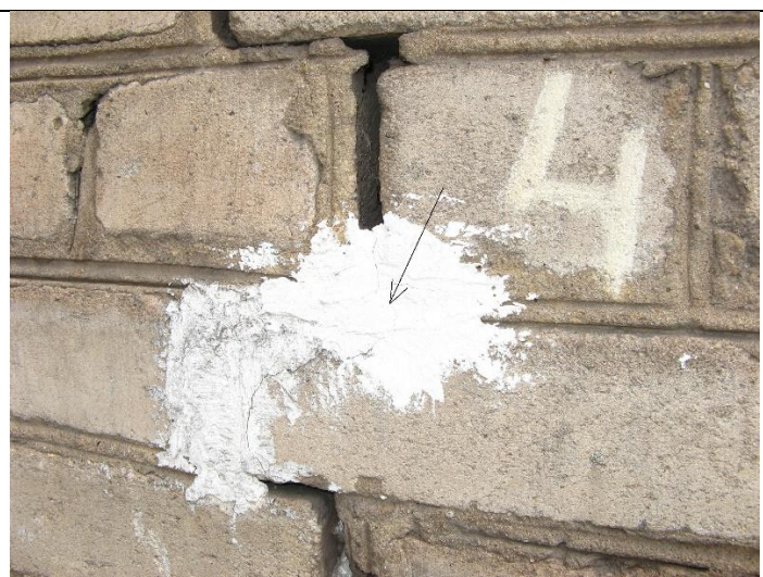
Рисунок 4.22 – Утворення тріщин в стіні будівлі Центру творчості «Мрія» після вибуху 10.09.08
