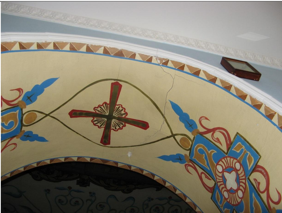
Рисунок 4.11— Тріщини в цегляному склепінні Церкви Різдва Богородиці по вул. Обручева, 14
