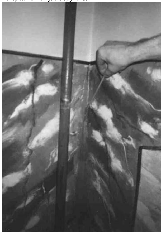
Рис. 3.26 – Похилі тріщини в стіні Церкви Різдва Богородиці по вул. Обручева, 14
