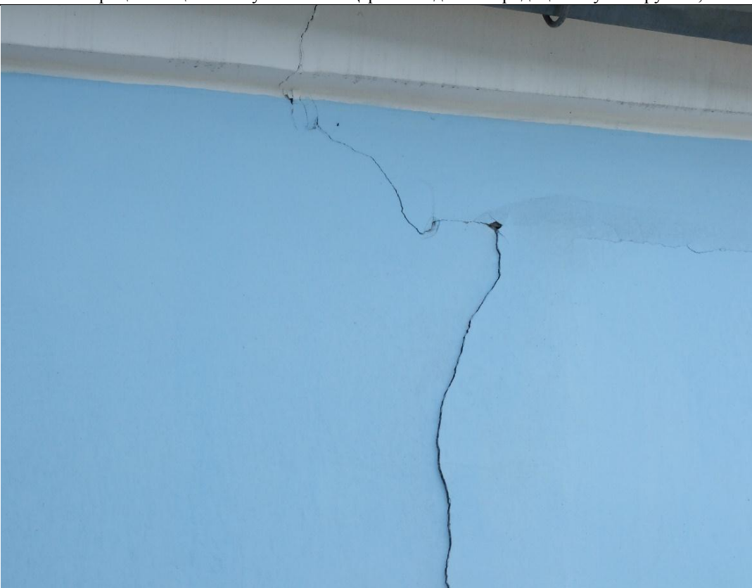
Рисунок 4.12 – Тріщина в зовнішній стіні будівлі Церкви Різдва Богородиці
