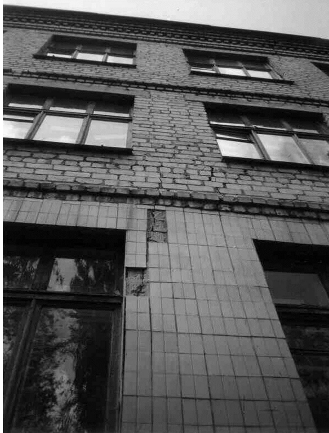
Рис. 3.6.2. Пошкодження будівлі середньої школи № 40 по вул. Сестроріцькій.
