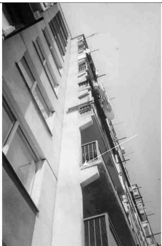
Рис. 3.32 – Характерні пошкодження несучих конструкцій будівлі №57 в мікрорайоні "Всебратьське-2"
