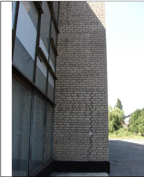
Рисунок 4.15 - Тріщина шириною розкриття до 1 см в нижній частині правої поперечної стіни біля центрального вітража
