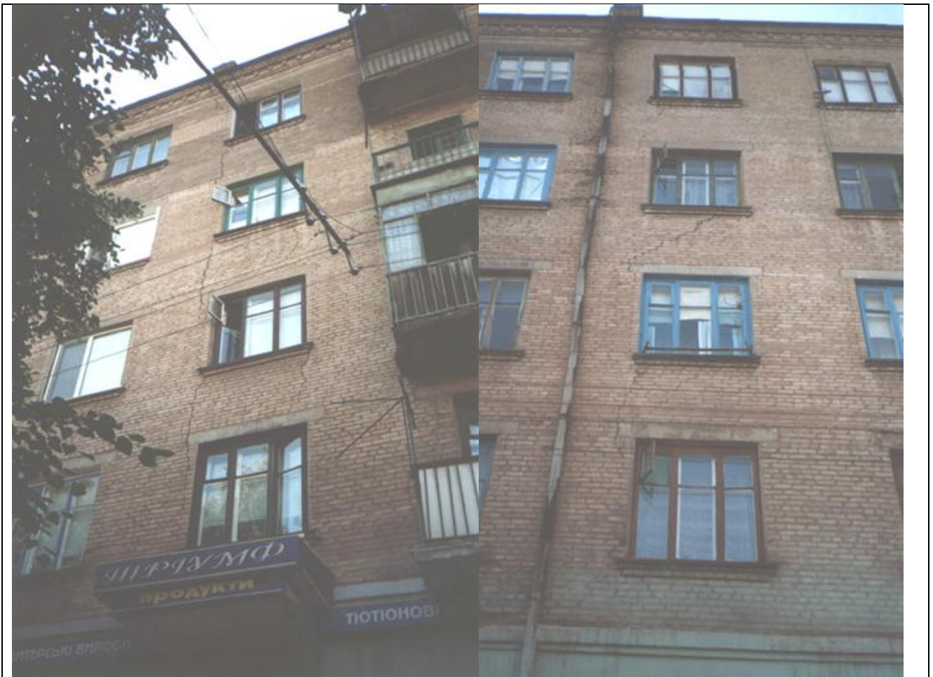
Рис. 3.50 – Вертикальні тріщини в стіні житлового будинку по вул. Кремлівській, 13
